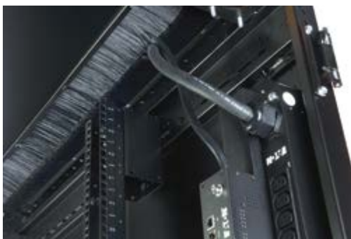
IT-Rack der Serie RP mit 2 installierten Eaton ePDUs
