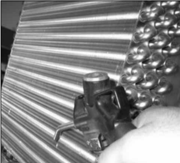
Abb. 27: Wärmetauschregister und Kompressorraum mit Druckluft ausblasen
