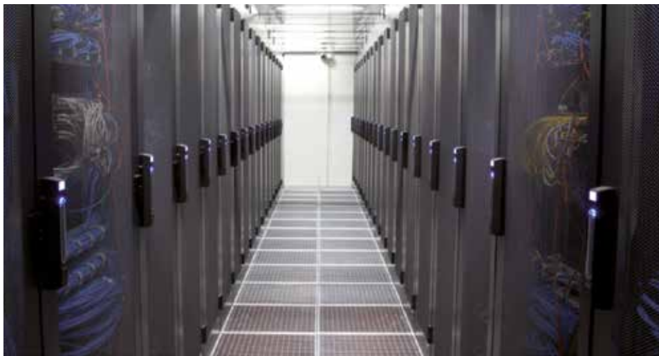
@lock Lösung mit MLR Griffen in einem Colocation Rechenzentrum
